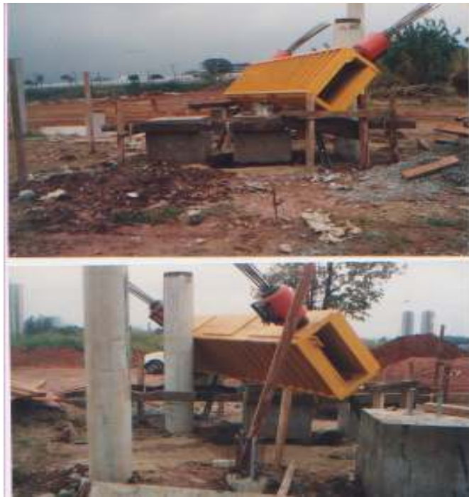
Figura 18 – Acidente com uma viga por falta de escoramento lateral
